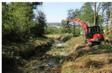
I lavori interesseranno innanzitutto il torrente Dogana, dall'immissione in Arno fino al Noferi, con le lavorazioni nella zona del Pestello
