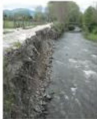
Ciclopista L'erosione delle sponde
